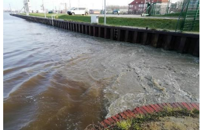
Betrieb des Hafenspumpwerks
